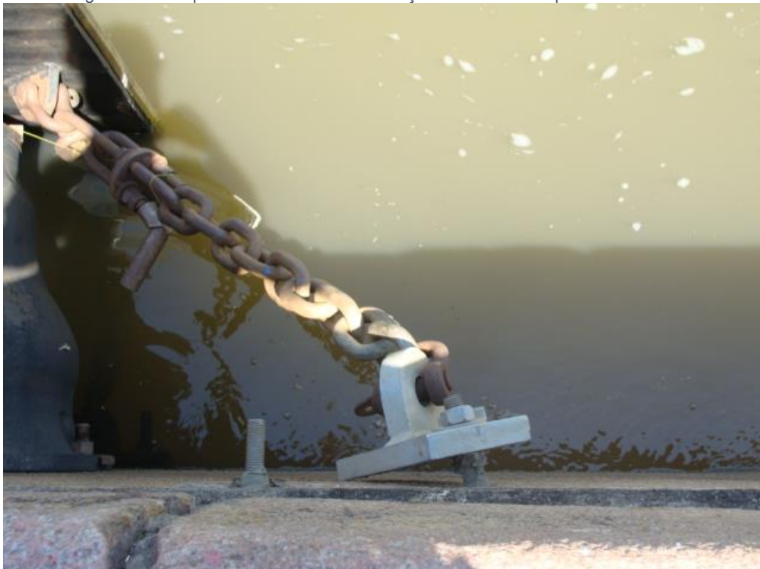
Figura 90 – Desprendimento de olhal de fixação de corrente no paramento do cais
