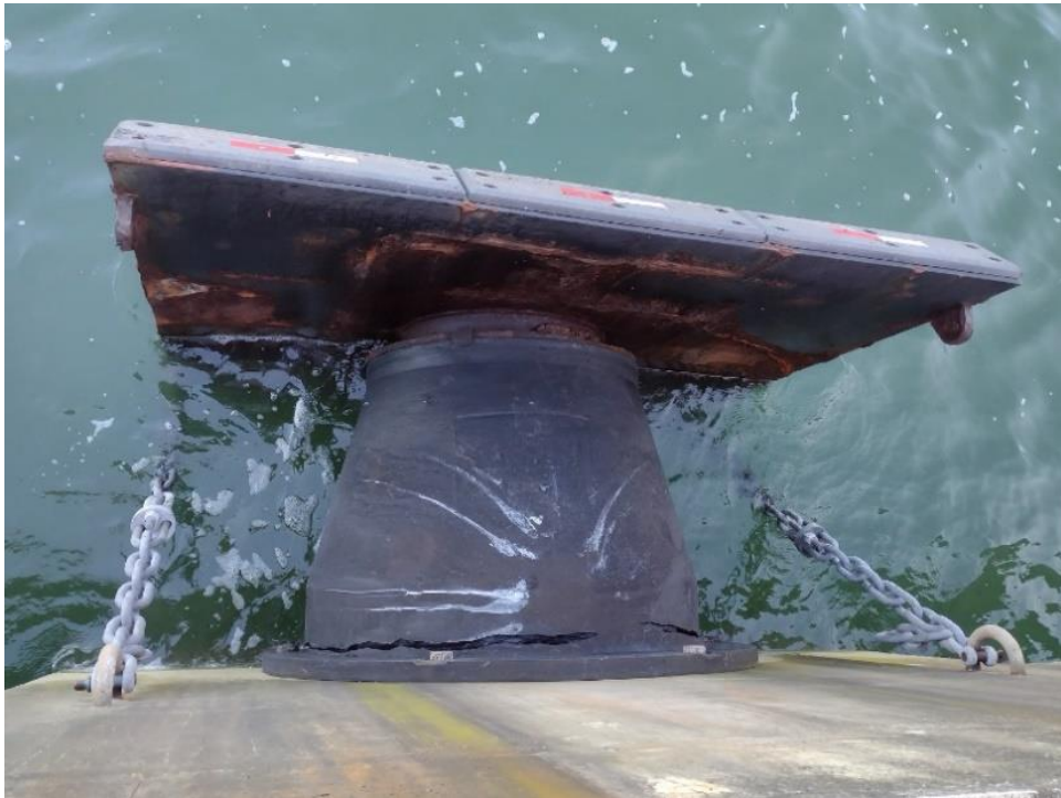
Figura 79 – Correntes de arraste faltantes que levaram a esforços laterais inadequados e a possível rompimento do elastômero
