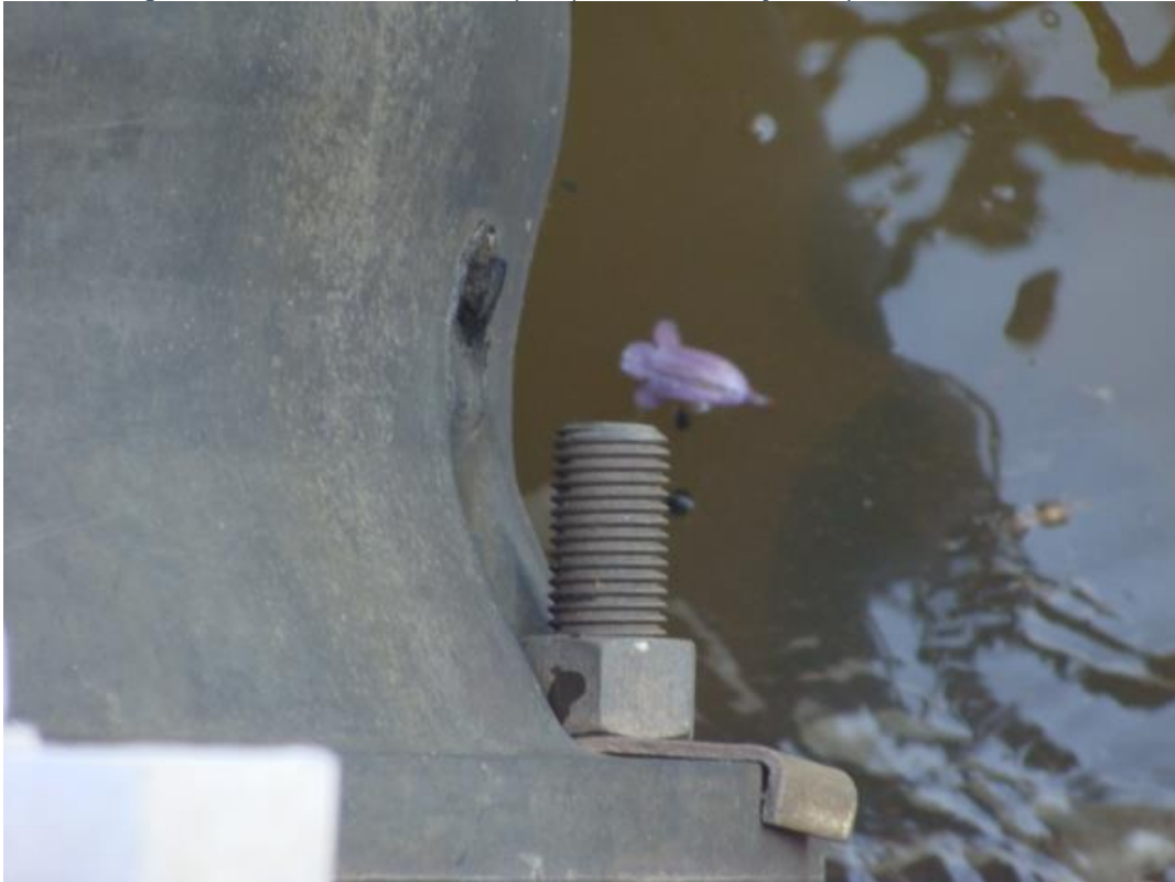
Figura 89 – Elastômero marcado pelo parafuso de fixação no paramento do cais
