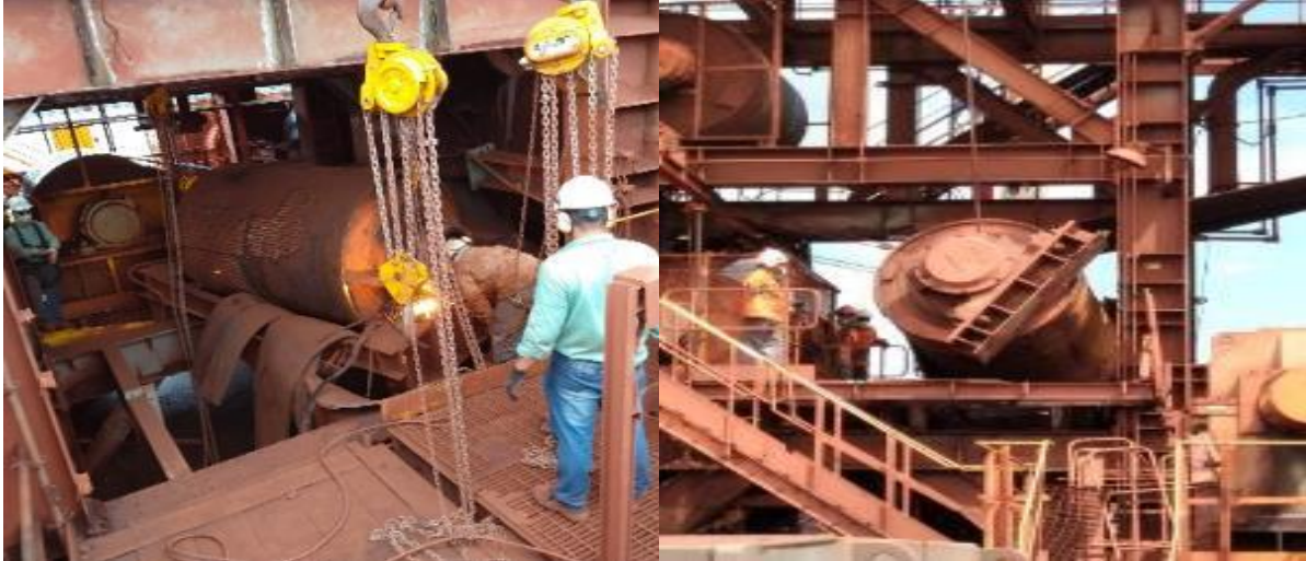
Figura 7 - Substituição de Tambor em Transportadores de Correia
