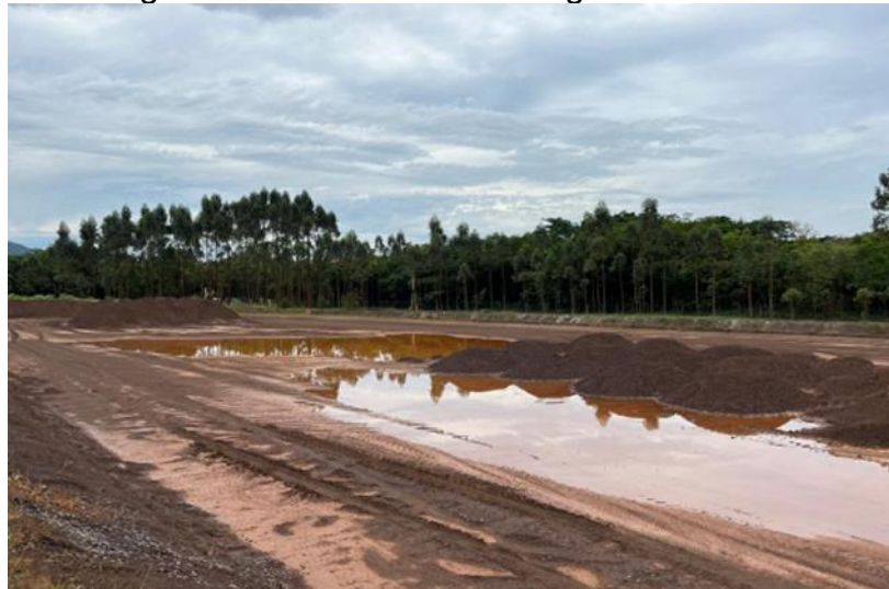
Figura 19 - Sistema de drenagem ineficiente
