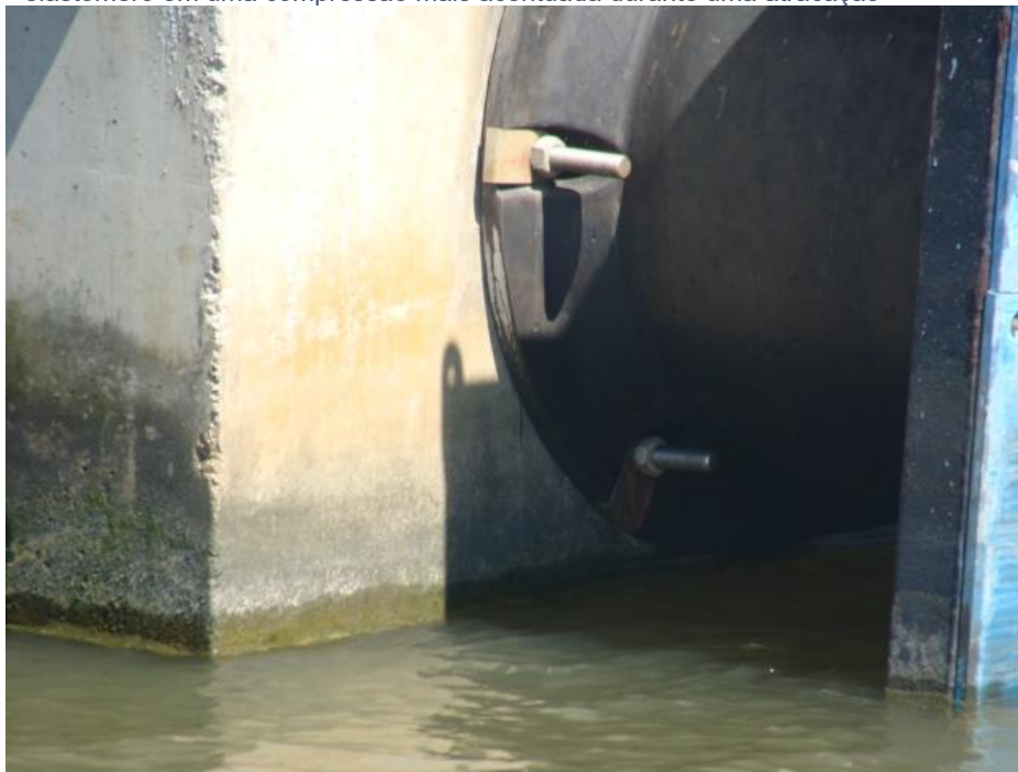
Figura 88 – Parafusos de fixação no paramento do cais com comprimentos inadequados que poderão rasgar o elastômero em uma compressão mais acentuada durante uma atracação
