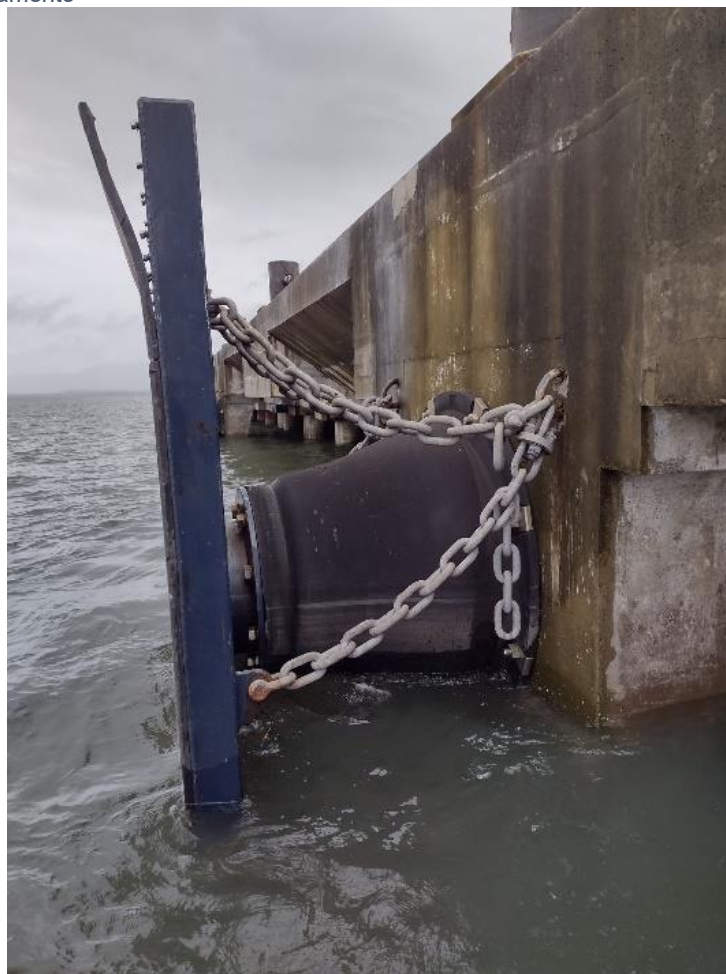
Figura 84 – Defesa parcialmente mergulhada na água – placa de UHMW solta e correntes sem o devido tensionamento
