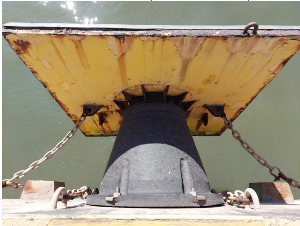
Figura 85 – Painel com corrosão excessiva e correntes quebradas e outras sem o adequado tensionamento
